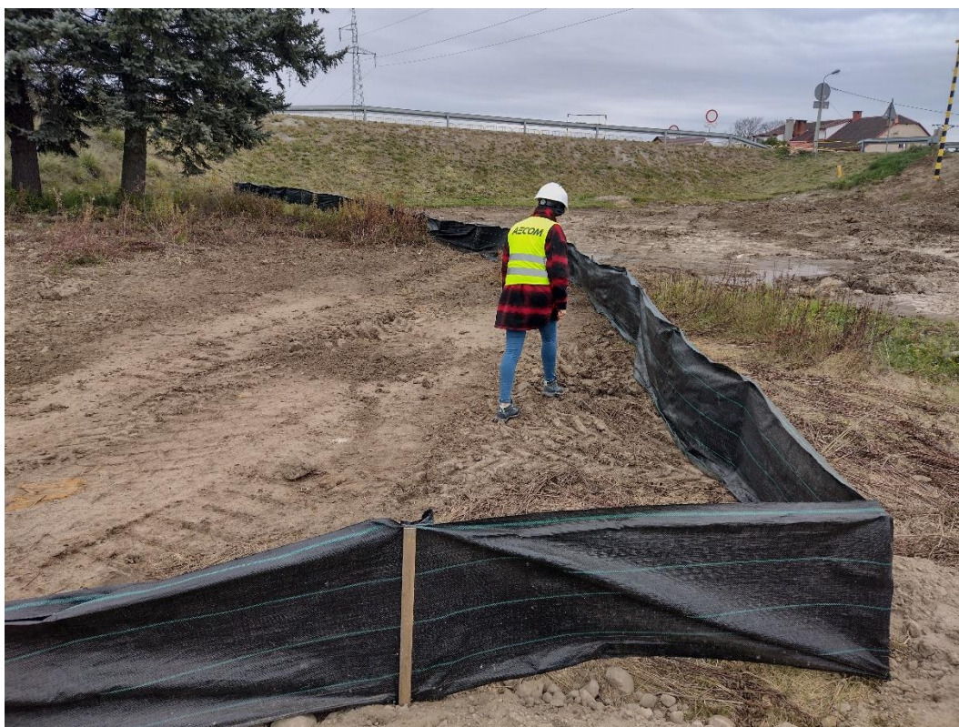
Fot. 17. Widok na prawy wał w km ok. 1+800 – monitoring przyrodniczy - kontrola otoczenie wygradzeń herpetofauny pod kątem aktywności płazów w okresie jesiennych migracji, październik 2021 r.
