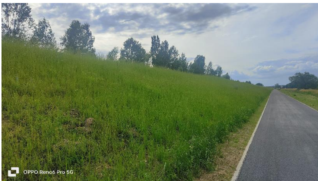
Fot. 40. Widok na wał prawy w km ok. 4+800 – zakończona budowa dróg przywałowych, widok na porost traw po obsiewie, czerwiec 2023 r.
