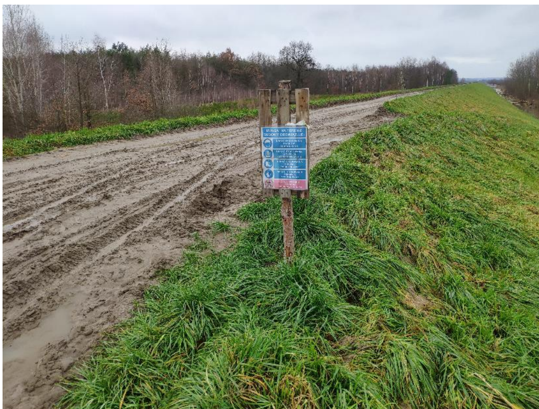
Fot. 35. Widok na lewy wał w km ok. 5+000 – oznakowanie terenu budowy, styczeń 2023 r.
