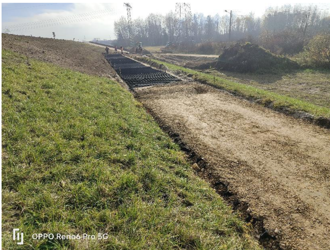
Fot. 31. Widok na lewy wał w km ok. 1+100 – widok na prace utwardzania dróg technologicznych, listopad 2022 r.
