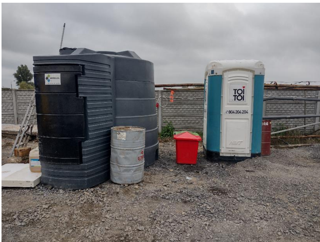
Fot. 3. Teren zaplecza budowy przy wale prawym – wyposażenie zaplecza m.in. w dostęp do sorbentów oraz urządzeń sanitarnych, wrzesień 2021 r.
