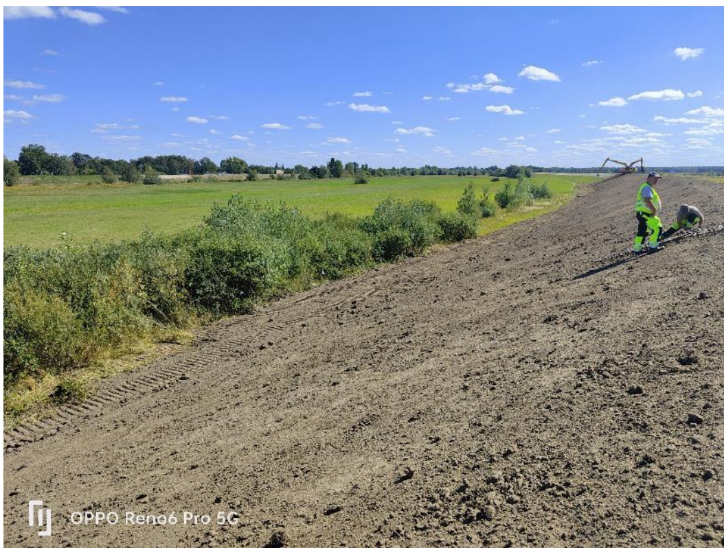
Fot. 25. Widok na lewy wał w km ok. 2+400 – rozplantowanie humusu po wykonaniu prac rozbudowy wału, wrzesień 2022 r.
